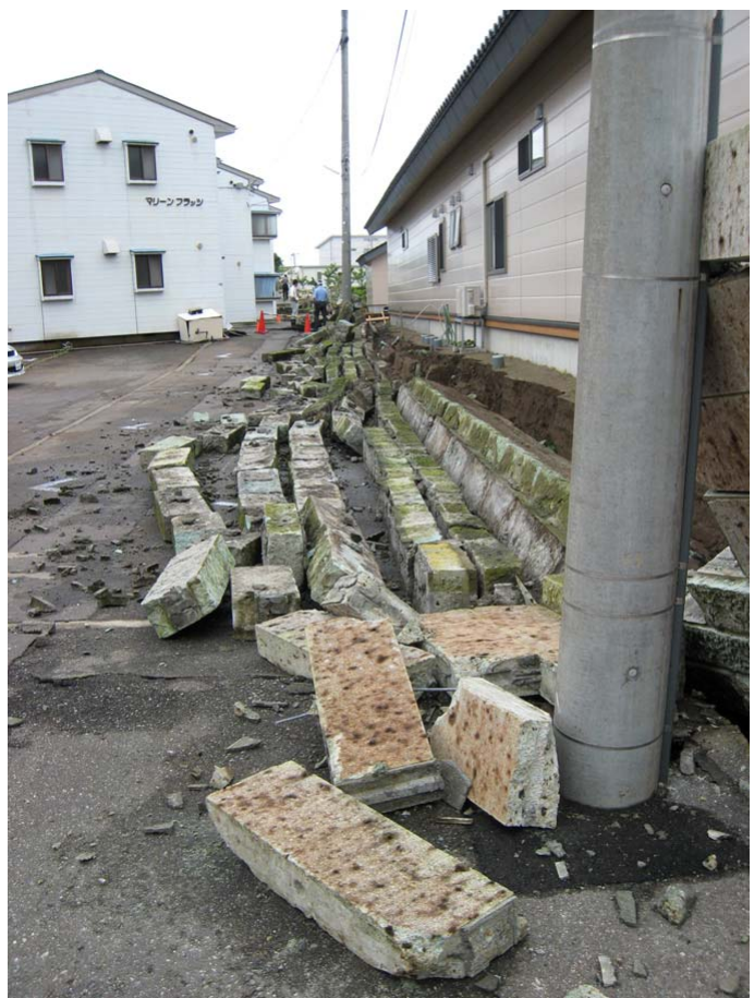
碧色の石のブロック塀 (無筋)の転倒
